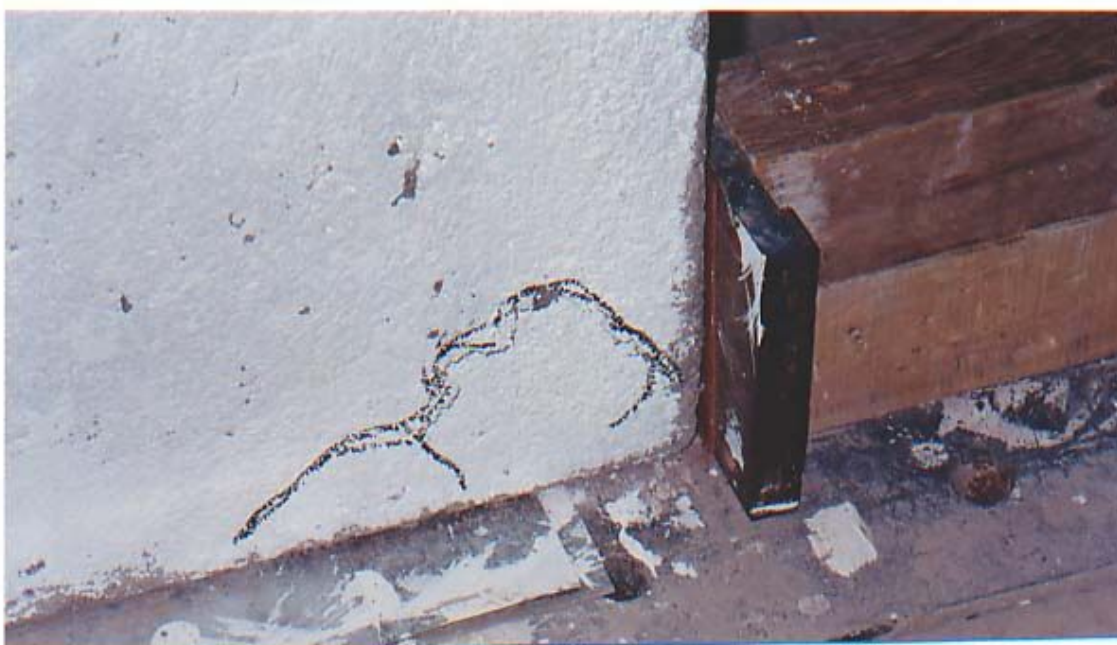
FOTO N° 4: Detalle del apoyo inferior del Panel P-H-03 después del ensayo de carga horizontal.
