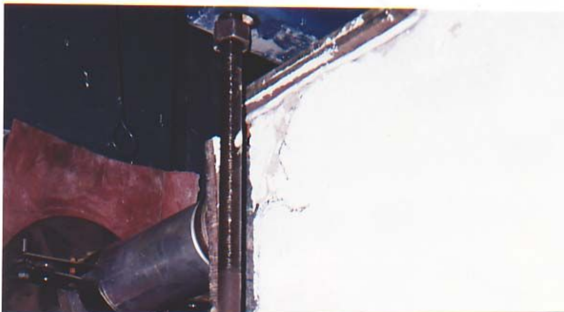
FOTO N° 3: Detalle de la falla por aplastamiento del punto de aplicación de la carga horizontal en Panel P-H-03 después del ensayo de carga horizontal.
